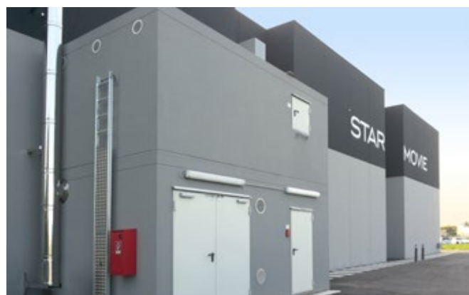
Dvonadstropna kontejnerska kotlovnica na lesne sekance ob javni stavbi.
