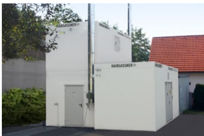
Trikontejnerska kotlovnica za gostinski lokal.
