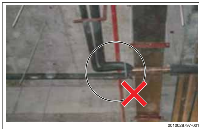
Slika 18 Pogrešno instaliranje cijevne mreže (primjer 2)
