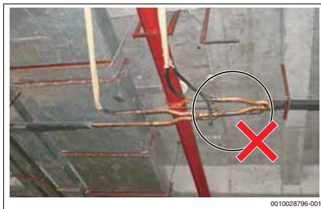
Slika 17 Pogrešno instaliranje cijevne mreže (primjer 1)
